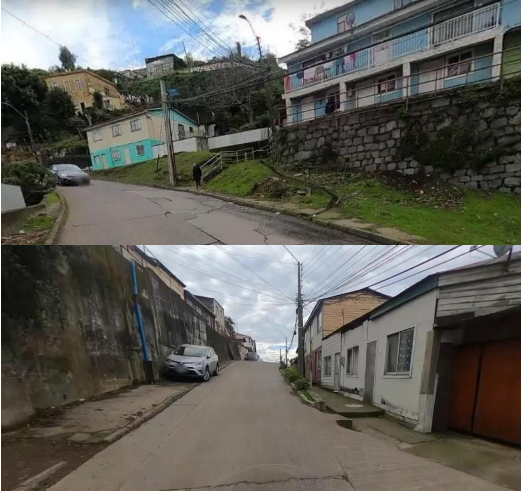
FIGURA 23.6-10: CERROS – ACERAS EN MAL ESTADO
